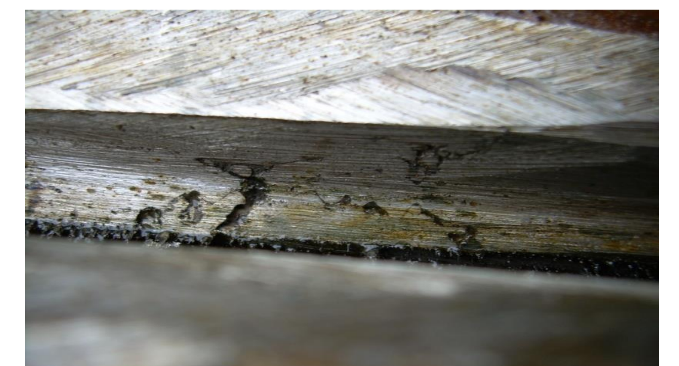
Рис.4 Дефекты сварного шва с выявленным критически активным источником АЭ (подтверждены УЗК и РК) после вырезки "катушки".
