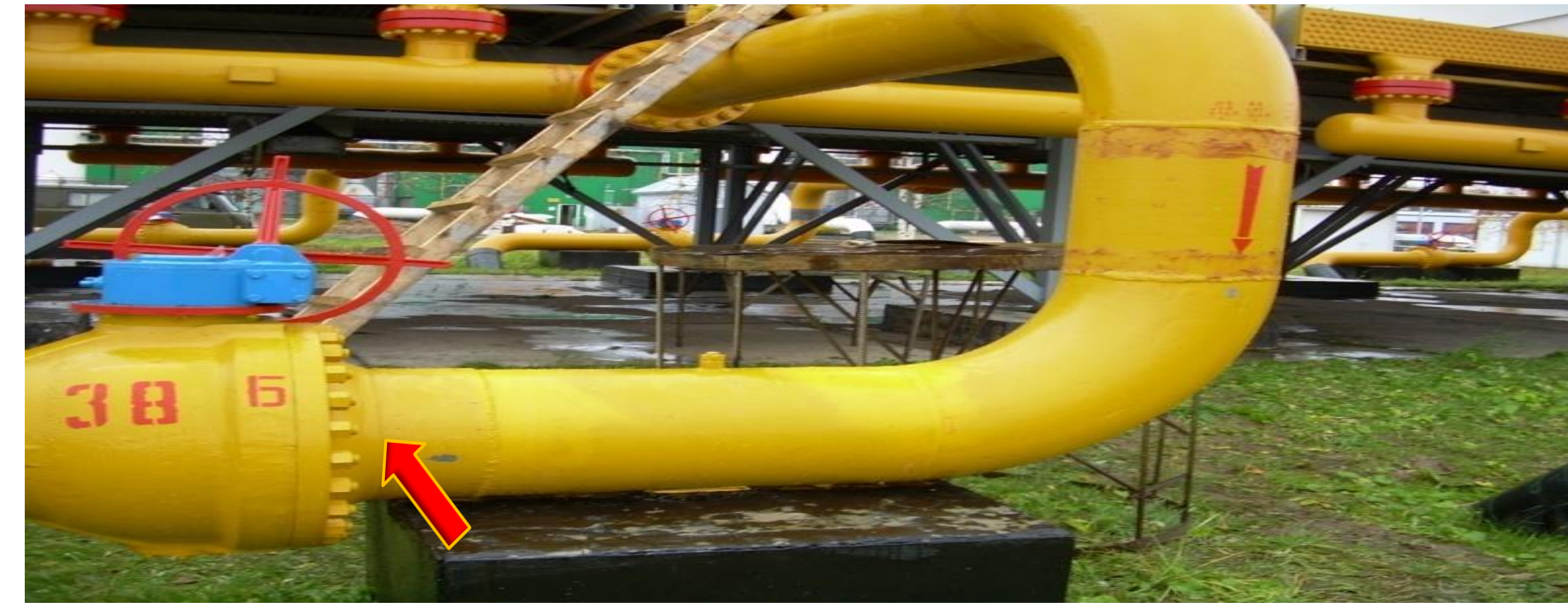
Рис.1 Участок технологического трубопровода с выявленным критически активным источником АЭ в сварном шве
